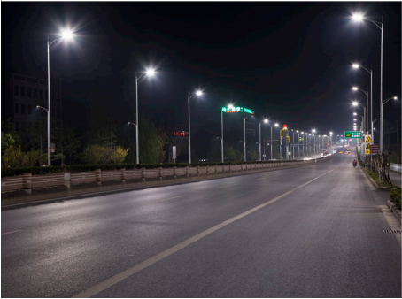
◀ 芜湖国道LED路灯改造项目
